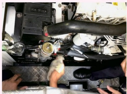
消防艇『ゆなぎ』の機関場
